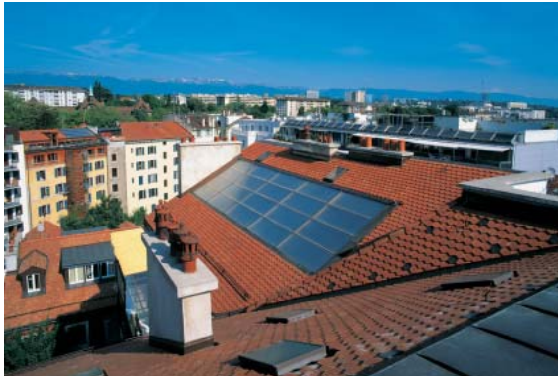
Exemples d'installations solaires thermiques dans le quartier de l'Ilôt 13 à Genève.
