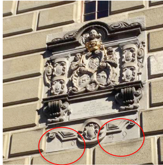
Figure 4: façade sud-est du clocher: plaque d'information rappelant l'achèvement de la reconstruction du clocher en 1649. Il s'agit d'un écriteau en grès de Molasse.
