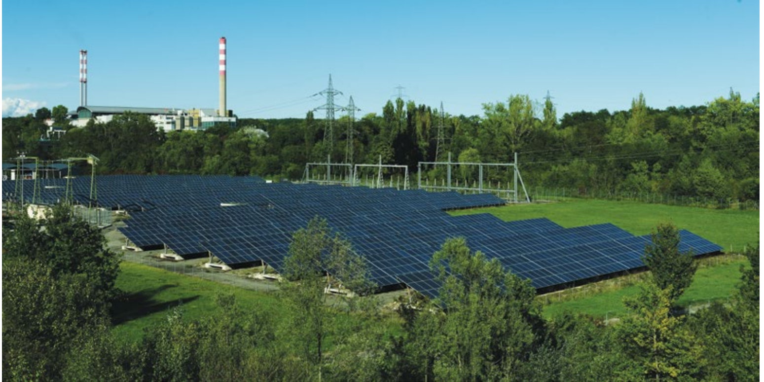
La centrale «SIG Solar 3», édifiée près du barrage de Verbois. Les Services industriels de Genève produisent près de 30% de l'électricité consommée à Genève, dont 88% d'hydraulique et 12% d'autres énergies renouvelables, solaire compris. Photo: SIG/Jay Louvion
