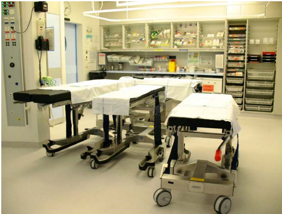
Sas de la Pédiatrie - Des lits sont préparés en vue d'une utilisation future avec des patients. Sur la gauche, on peut remarquer la présence d'un téléphone. Ceux-ci sont omniprésents dans les blocs opératoires...
