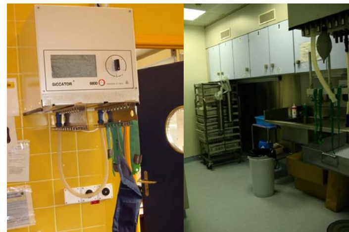
A gauche : appareil pour sécher les tubes et tubulaires. A droite, local de décontamination en PEDIATRIE
