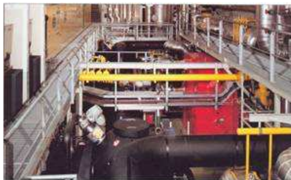
Pompe à Chaleur vue des passerelles
