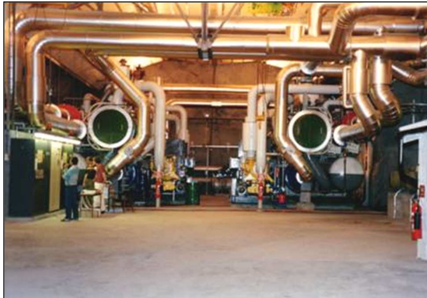
Salle des machines, 2 Unitop® 28/28 Avec les conduites de distribution
