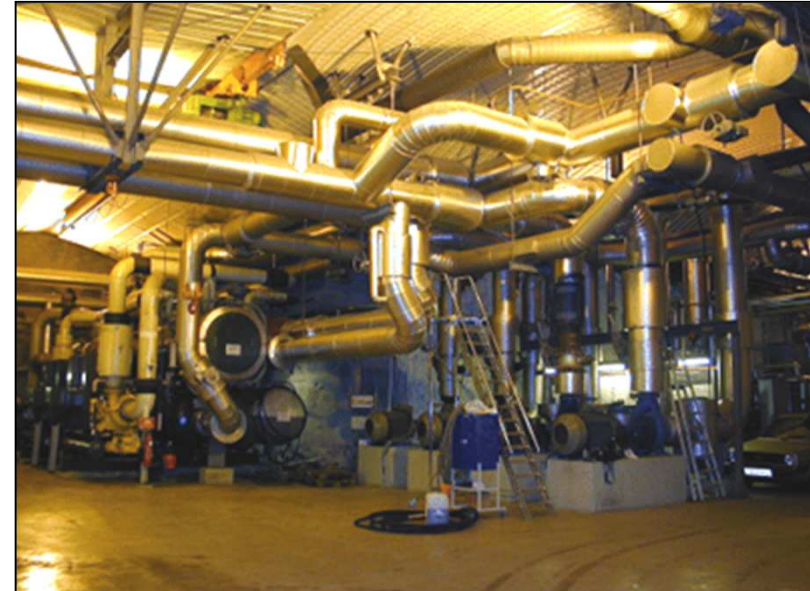
Salle des machines, à gauche Unitop® 28/28, À droite: Pompes de distribution froid / chaud
