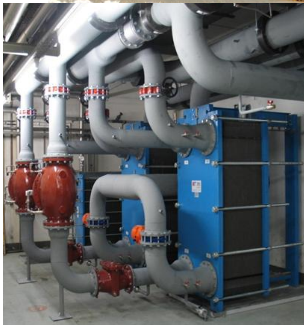
Sous-station client 2 x 3 MW
